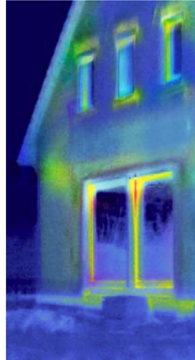
Vor der Renovierung: Hohe Wärmeverluste sind im Bild rot dargestellt.
